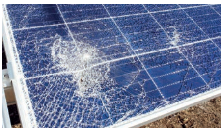
Photo 26 : Panneau photovoltaïque endommagé (© Andrei Merkulov/AdobeStock)
