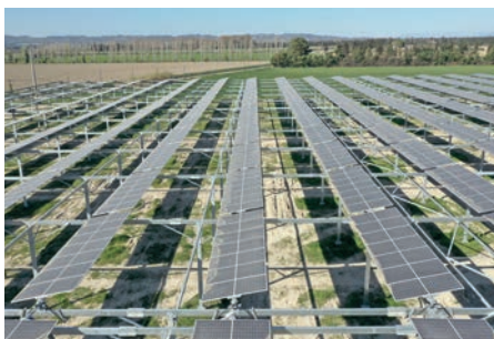
Photo 17 : Ombrières photovoltaïques au Cabanon (© Voltalia)
