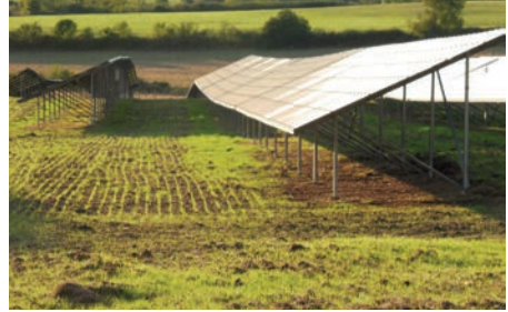
Photo 56 : Prairie semée dans un parc photovoltaïque (© E. Mortelmans)
