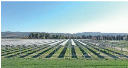
Photo 1 : Ombrières photovoltaïques installées au dessus de cultures maraîchères (© Voltalia)
