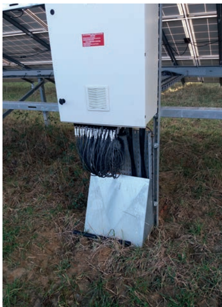
Photo 33 : Câblages électriques laissés apparents à faible hauteur pouvant être rongés par les animaux (© Idele)
