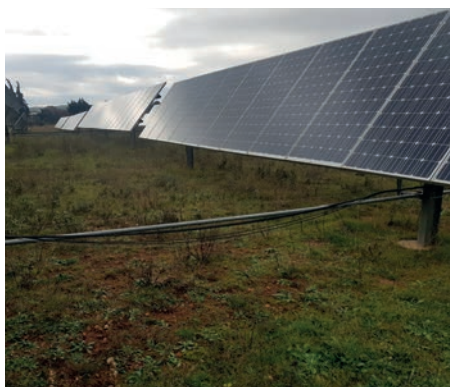
Photo 25 : Des barres de commande trop basses dans un parc photovoltaïque trackers 1 axe d'ancienne génération (©Idele)
