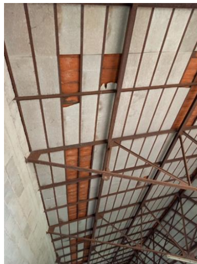
Illustration n° 41 : Toiture avec amiante
