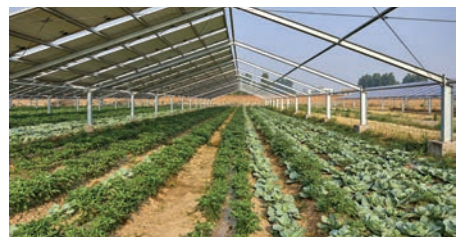
Photo 4 : Ombrières photovoltaïques mobiles installées au-dessus de cultures maraîchères (© Jeson/AdobeStock)
